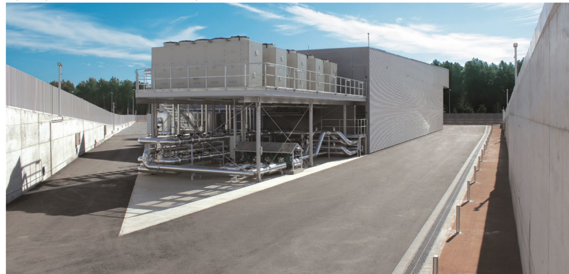
T-System: implementazione del data center modulare Cerdanyola del Vallès, Barcellona.
